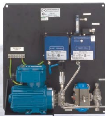
Ячейка контроля насоса системы Smart ODME
